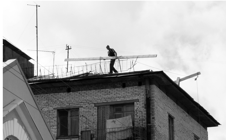
Зачастую строители работают на крышах без страховки.
